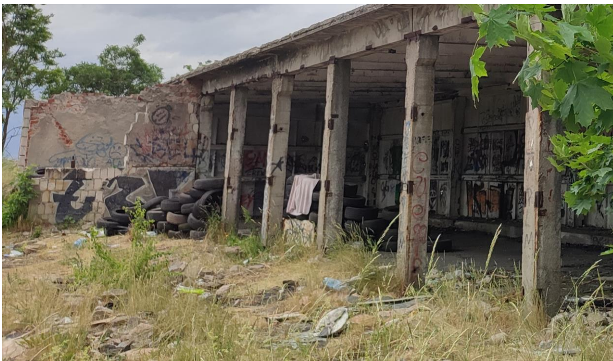
Zdj. 1. Odpady z grupy 16, 17 i 20 widoczne na terenie planu (autor zdjęcia: M. Chawrińska, 14-06-2023).
