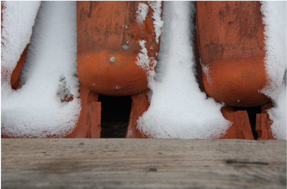
Fot. 6 Nieszczelne dachówki przy drewnianym parapecie jednej z lukarn.
