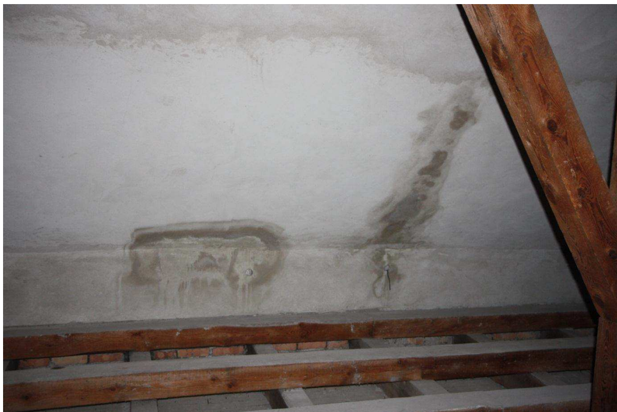
Fot. 8 Wnętrze środkowej części poddasza. Fragment południowej połaci poddachowej. Wyraźne zacieki na tynku cementowo-wapiennym świadczą o nieszczelnościach dachu.
