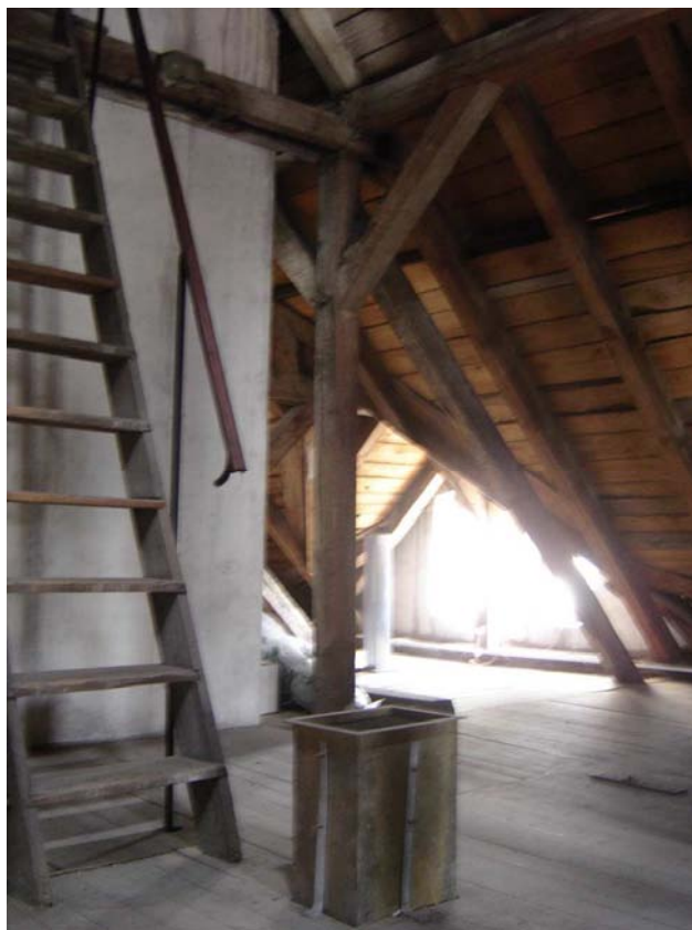
Poddasze – wentylacja z dolnych pomieszczeń wyprowadzona w przestrzeń strychu.
