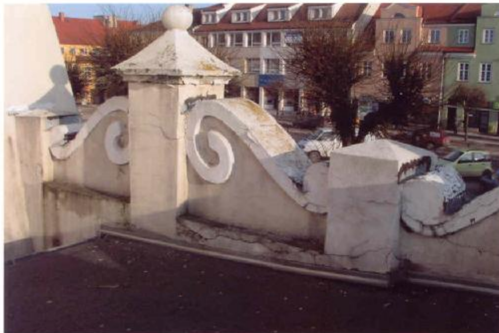
Fot.17. Wewnętrzna strona muru od południa. Pęknięcia tynku występują na większości detali. Zbyt mocna zaprawa tynkarska i uszczelniająca powłoka farby elewacyjnej (prawdopodobnie akrylowej) utrudnia odparowywanie wody z wnętrza muru.
