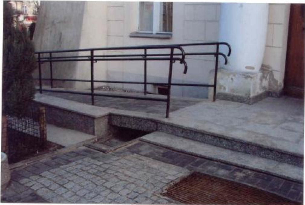
Fot. 31 Prawidłowo wykonany podjazd od strony północnej i wadliwe (nie zgodne z normami) wykonane łączenie bruku z pierwszym stopniem. Pierwszy stopień powinien być równy drugiemu, lub na poziomie bruku.
