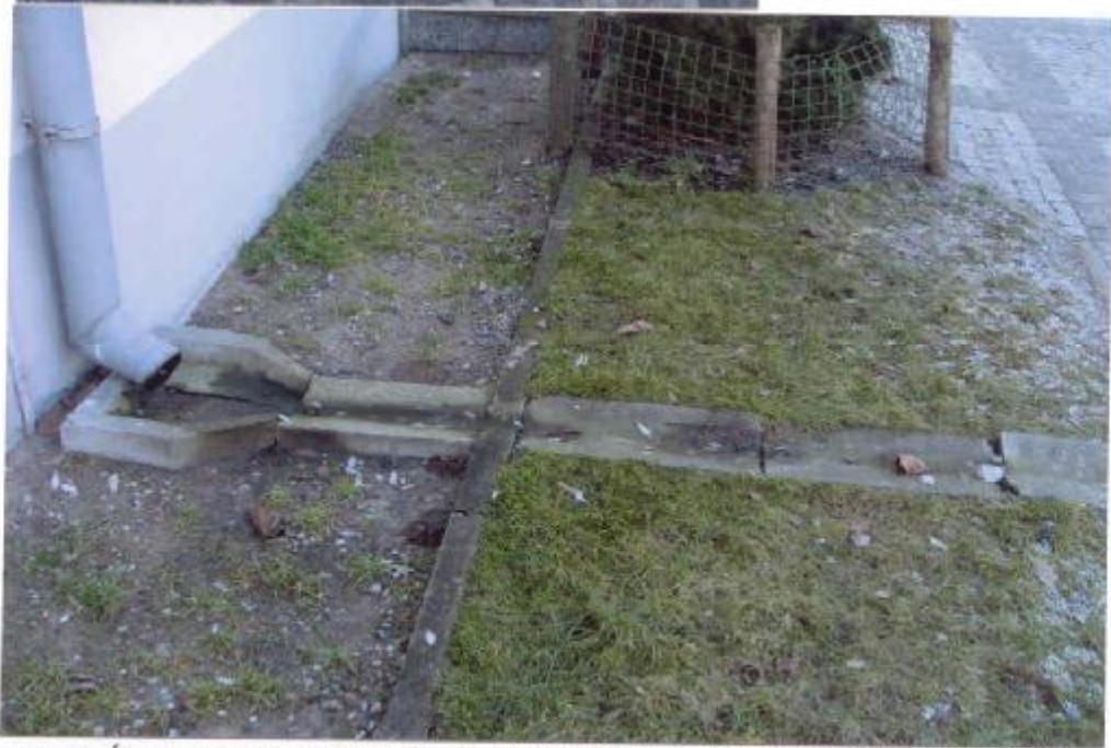
Fot 35, 36 Źle wykonane odprowadzenie wody opadowej. Woda przenika w większości pod fundamenty budynku. Woda nie powinna płynąć na wierzchu i być kierowana na chodnik. Rura spustowa powinna odprowadzać ją bezpośrednio do studzienki pod murem, a następnie systemem drenów powinna spływać do sieci miejskiej
