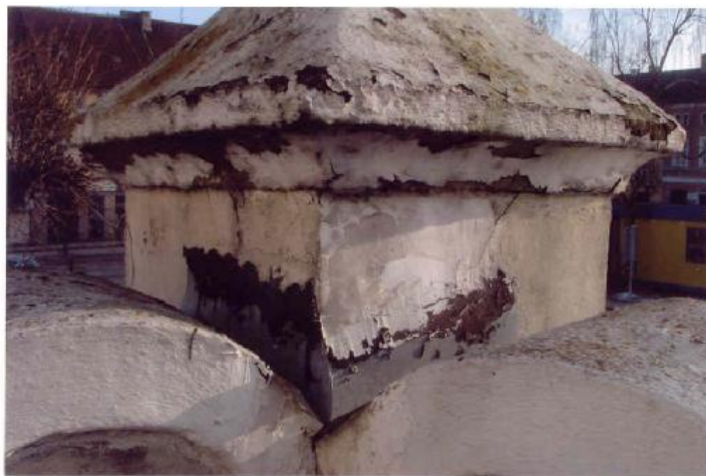
Fot. 25 Prowizoryczne i nie właściwe uzupełnienie tynku niskoporowatą zaprawą klejową.
