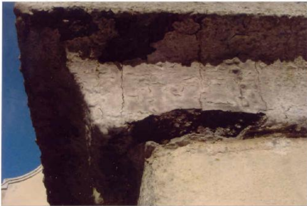
Fot. 21, 22 Sterczyny silnie pękają i osypują się.
