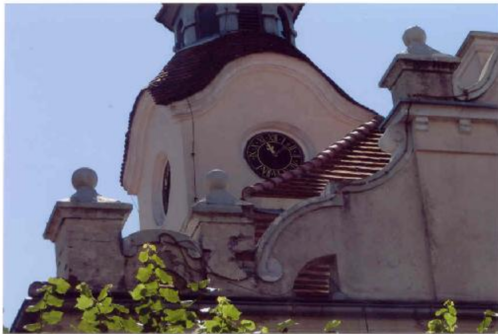
Fot.7 i 8 Fragment wieży ratuszowej. Widoczna silnie zluszczająca się farba.
