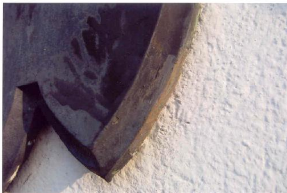
Fot. 42 Fragment metalowej tarczy. Na krawędzi wykonano odkrywkę. Na metalu występuje tylko jedna warstwa farby. Pod nią widać warstwę korozji.
