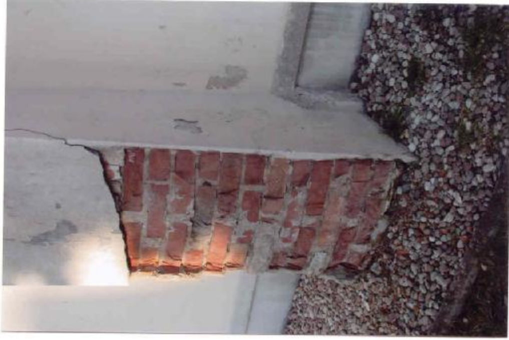
Fot. 12 Fragment przypory od strony zachodniej. Zbyt mocny i szczelny tynk odpada od muru wraz z fragmentami powierzchniowymi cegieł.
