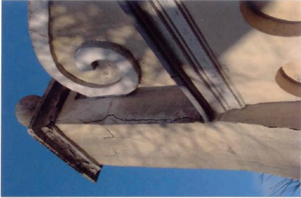
Fot. 11 Pn-Zach narożnik muru. Głębokie i rozległe pęknięcia tynku przyspieszają procesy destrukcyjne.
