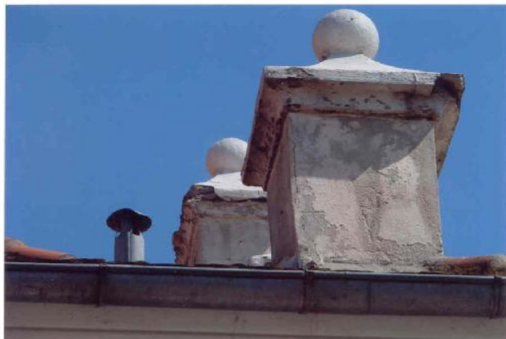
Fot.19, 20 Sterczyny silnie pękają i osypują się.
