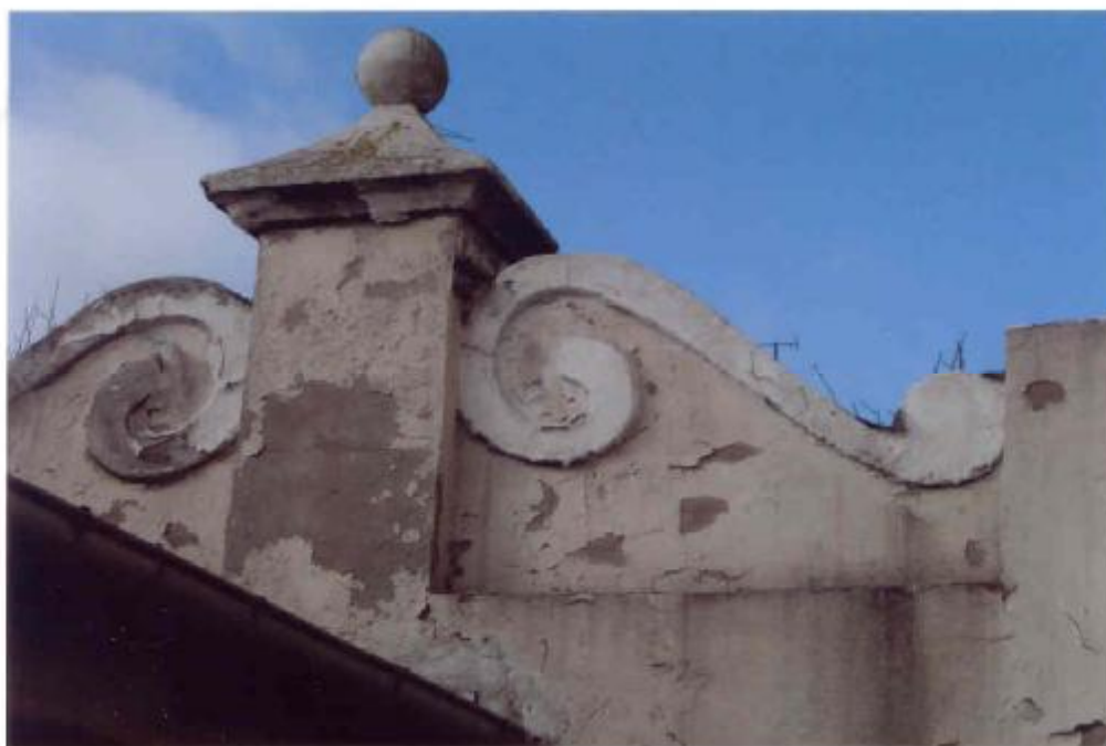
Fot. 18 Silne złuszczenia farby
