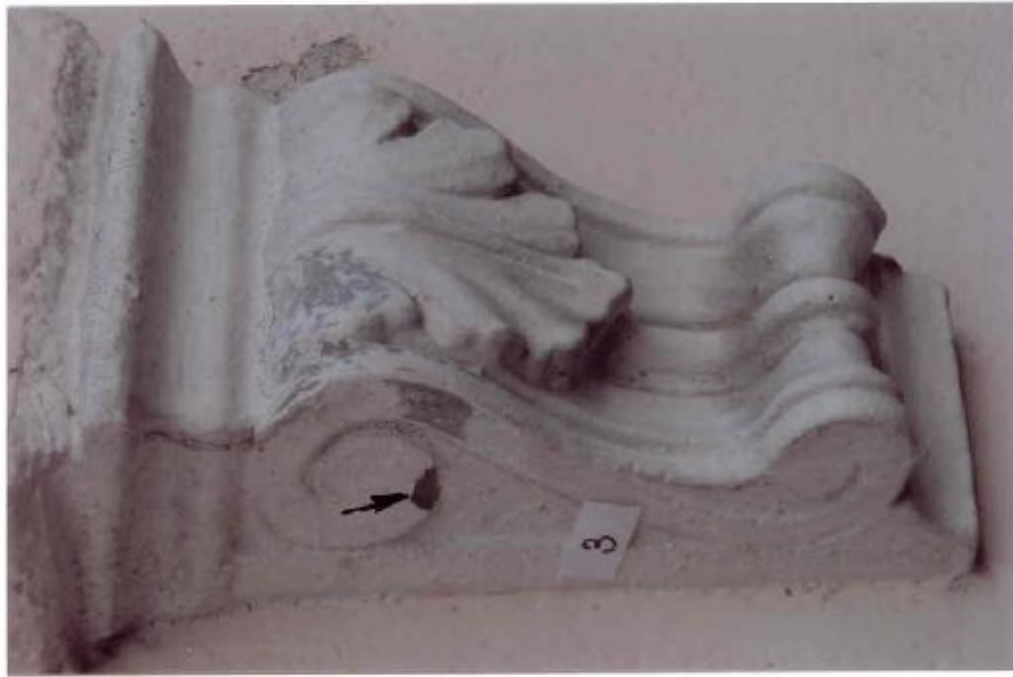
Fot. 75 Konsola odlana z bardzo twardej zaprawy cementowej, zawieszona na murze od strony zachodniej. Wykonano odkrywkę i zaznaczono miejsce pobrania próbki 3.
