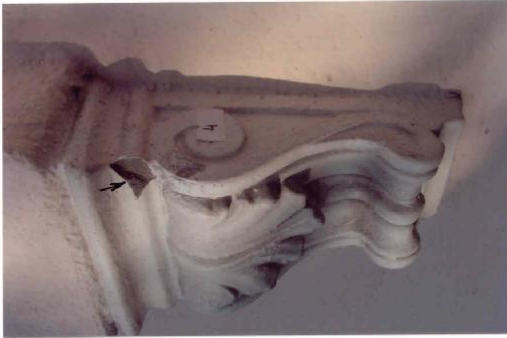
Fot. 77 Konsola odlana z bardzo twardej zaprawy cementowej, zawieszona na murze od strony zachodniej. Wykonano odkrywkę i zaznaczono miejsce pobrania próbki 4.
