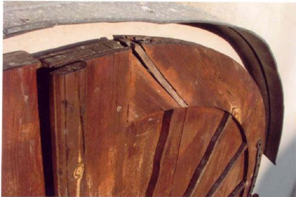
Fot. 30 Górny fragment bramy. Paczące się i rozchodzące drewno wymaga pilnej konserwacji.
