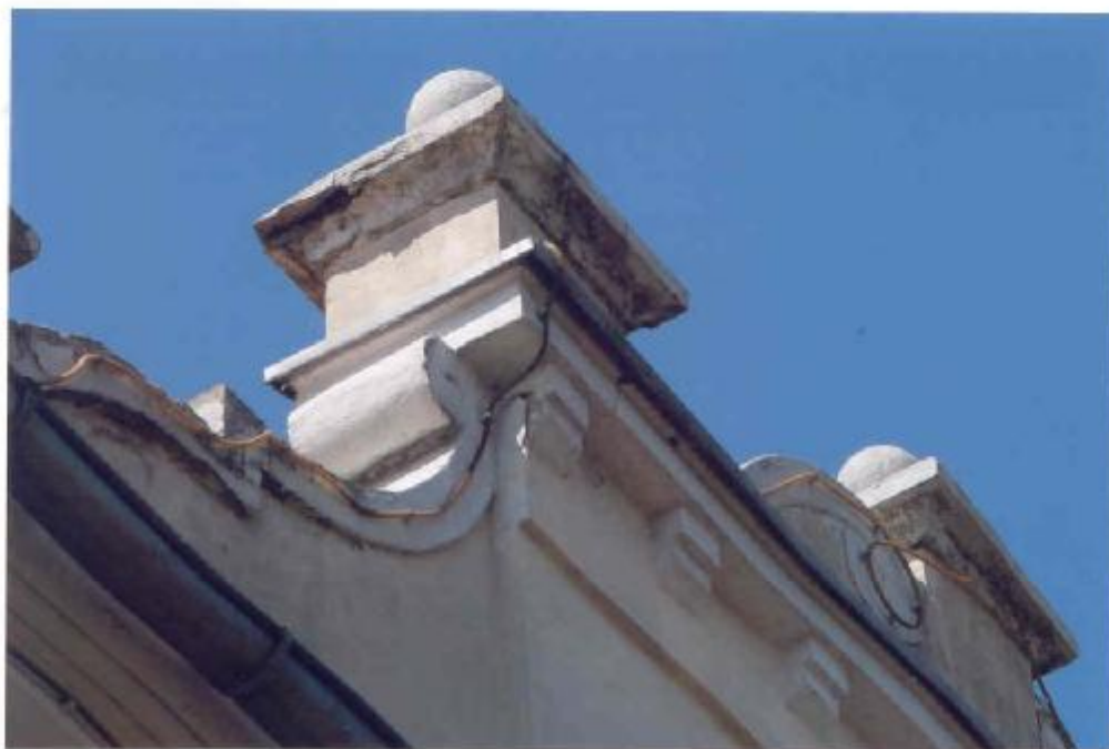
Fot.13 Fragment attyki. Widoczne pęknięcia profilowania i złuszczenia farby elewacyjnej.
