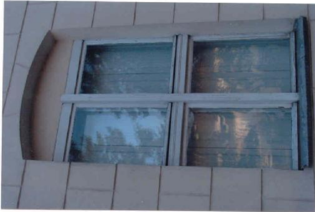
Fot. 49 Pozbawione szczebliń okno na parterze elewacji wschodniej.
