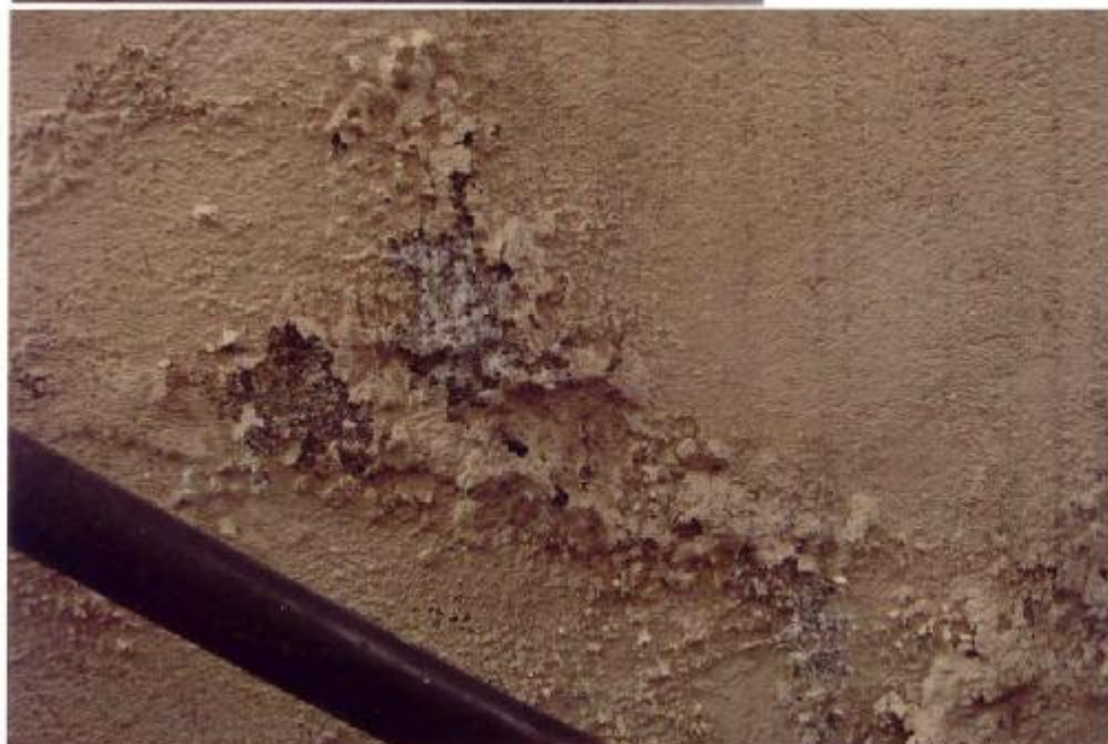
Fot. 40 Wykwity solne na murku, przy zejściu do kotłowni.
