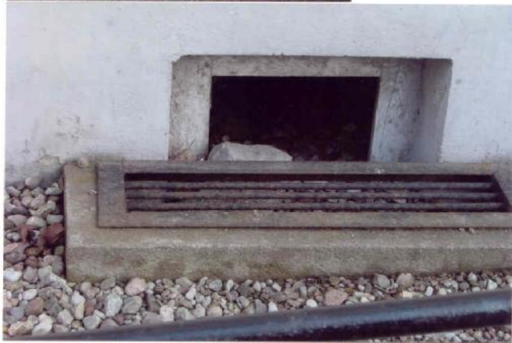
Fot. 33 i 34 Okna piwniczne pozostają otwarte.
