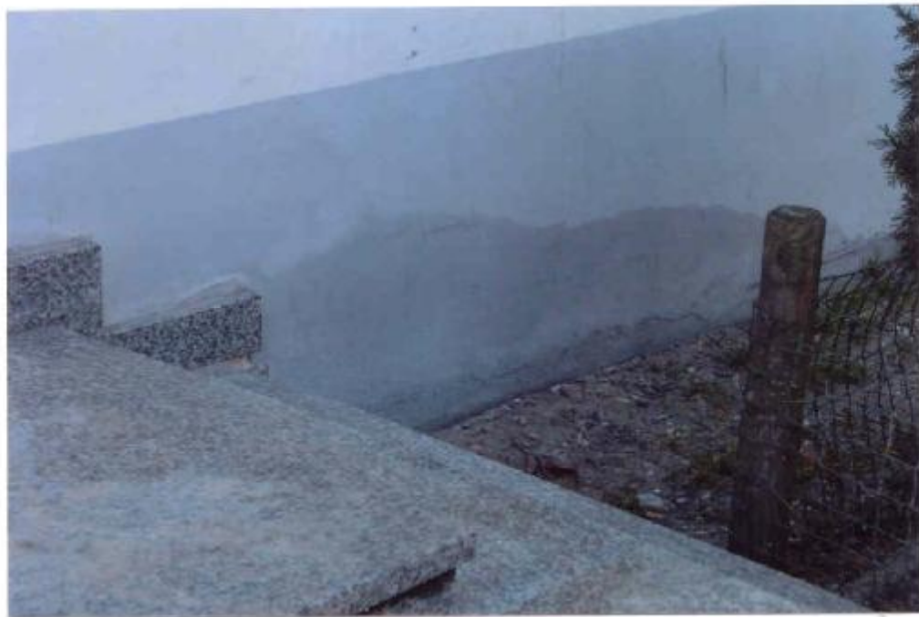
Fot. 37, 38 Odgruntowe zawilgocenie muru tuż przy wejściu od wschodu.
