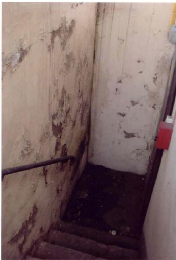
Fot 39 Zawilgocone, pokryte wysoleniami i porostami, zejście do kotłowni od strony podwórza.
