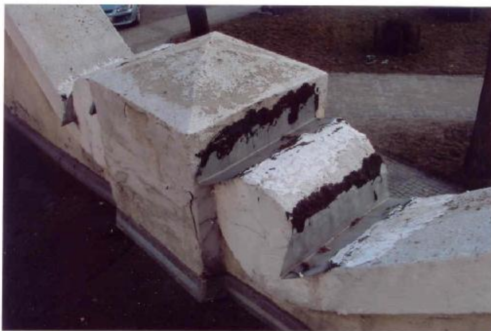
Fot. 26 Szczyt muru próbowano uszczelnić poprzez przyklejenie i zasmolowanie kawałków blachy ocynkowanej.
