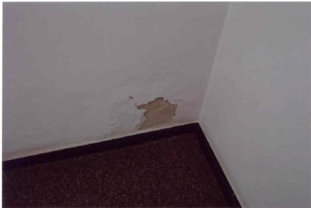
Fot. 56 Zawilgocenie muru na półpiętrze. Powód nie rozpoznany.
