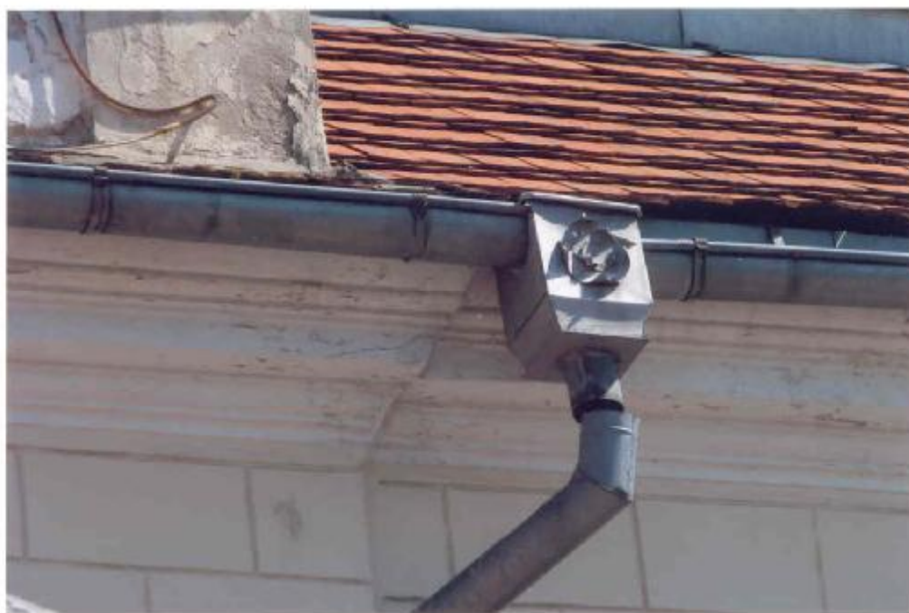
Fot.14 Uszkodzona rura spustowa.
