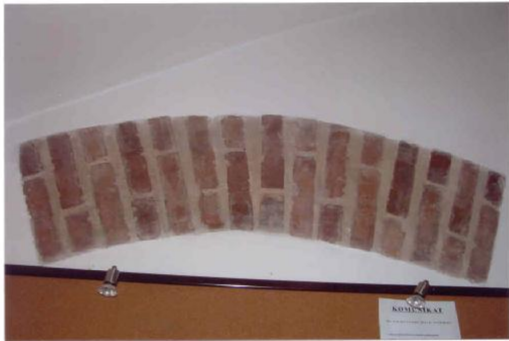
Fot. 55 Odsłonięty wążek łuku nadokiennego na parterze. Mur od strony północnej. W tym miejscu, przed 1920 było okno.
