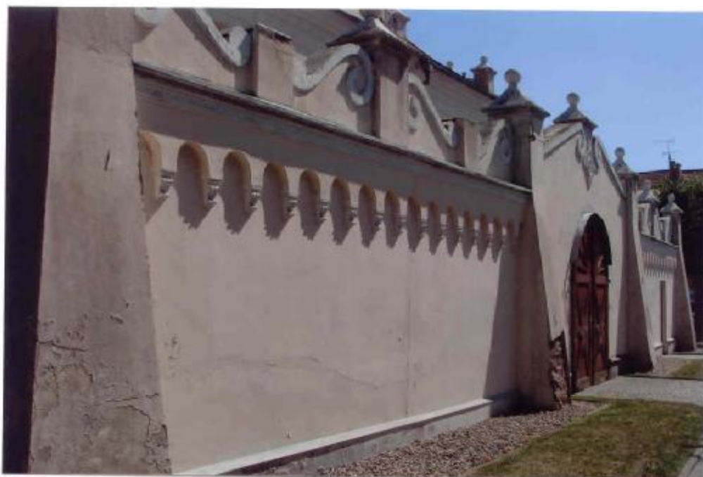
Fot.9 Mur od strony zachodniej. Powierzchnię tynku w wielu miejscach zatarto nie równo – np. nad bramą. Widoczne rozległe pęknięcia i odspojenia.
