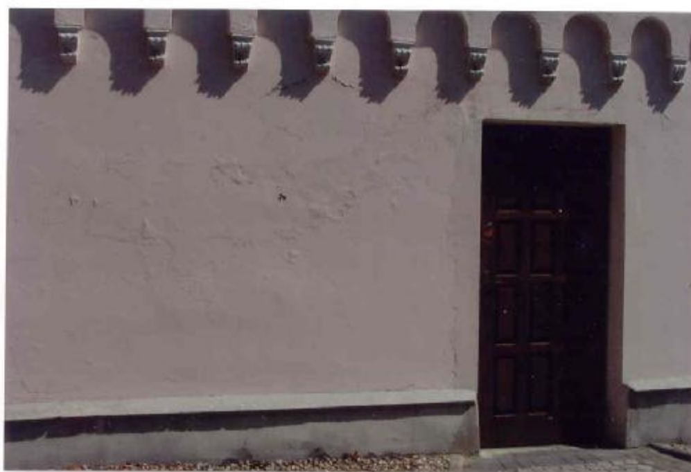
Fot.10 Nie równo zatarty tynk (szczególnie wokół wejścia). Otwór drzwiowy wykuto w tym miejscu prawdopodobnie w 1914. Na zdjęciach sprzed I Wojny Światowej jeszcze nie istnieje. Fotografia wykonana po 1921 dowodzi, że początkowo był zwieńczony łukiem odcinkowym. Cokół muru otynkowano wtórnie prawdopodobnie w latach 80-tych. Jeszcze w czasie II Wojny Światowej był kamienny.
