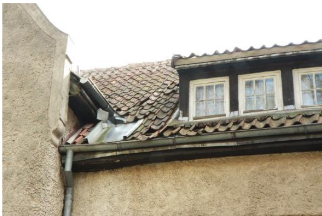
Fot. 20 Fragment uszkodzonego i prowizorycznie łątanego dachu od strony Pn-Wsch.
