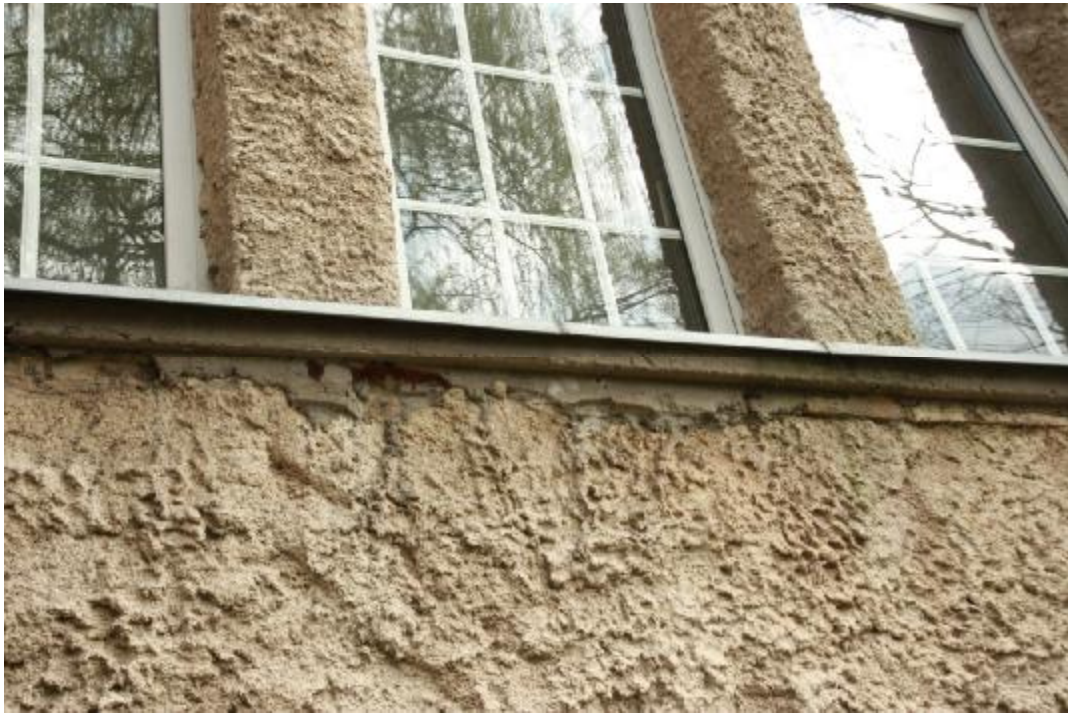
Fot. 30 Niestarannie wykonany, przypadkową zaprawą, gzyms podokienny na elewacji frontowej.
