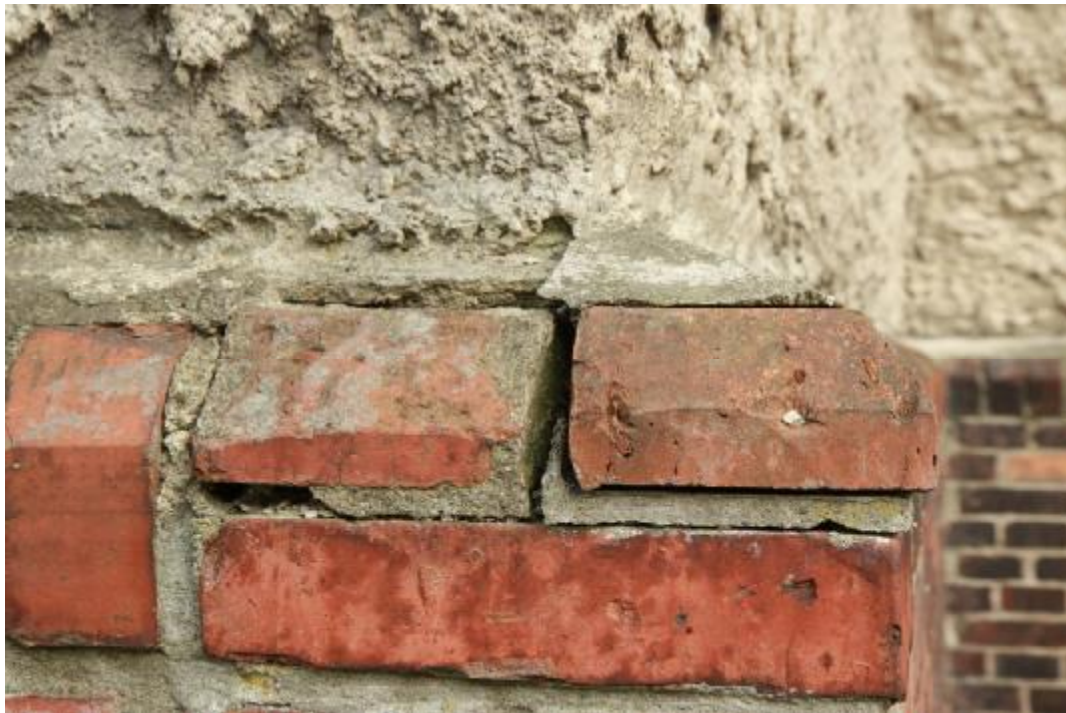
Fot. 33 Luźne cegły cokołowe na elewacji frontowej.
