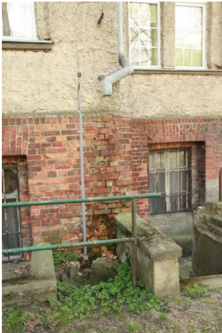
Fot. 36, 37 Północny narożnik budynku. Widoczne zacieki na murze i zniszczenia cegieł spowodowane lejącą się wodą opadową z urwanej rury spustowej. Obok duże ubytki w murku. W tym kształcie jest on konstrukcją wtórną.
