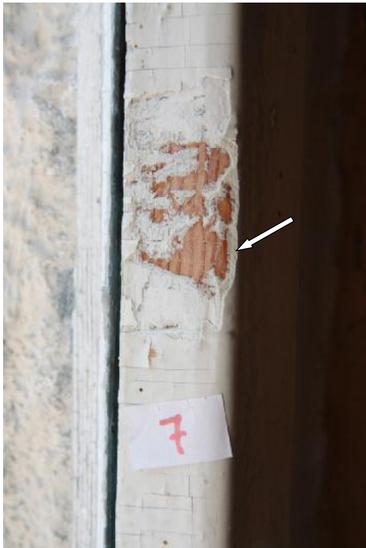
Fot.92 Fragment skrzydła okna przy schodach prowadzących na strych. Odkrywka i miejsce pobrania próbki 7. Najwcześniejsza warstwa jest w odcieniu szarym.
