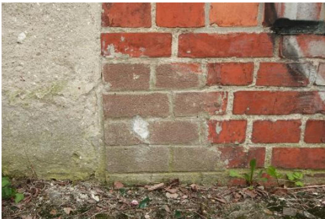
Fot. 27 Uzupełnienia ubytków w ceglach wykonane zaprawą niewłaściwie dobraną pod względem koloru i faktury.
