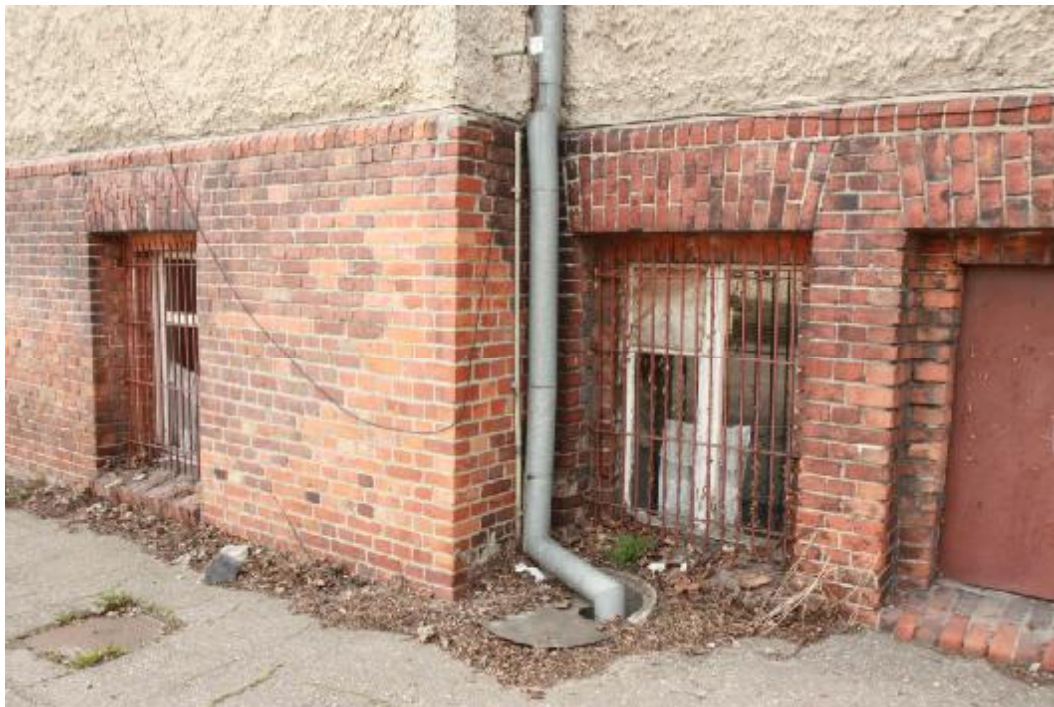
Fot. 26 Fragment elewacji Pd-Wsch. W tym miejscu dużą część cokołu uzupełniono nową cegłą.
