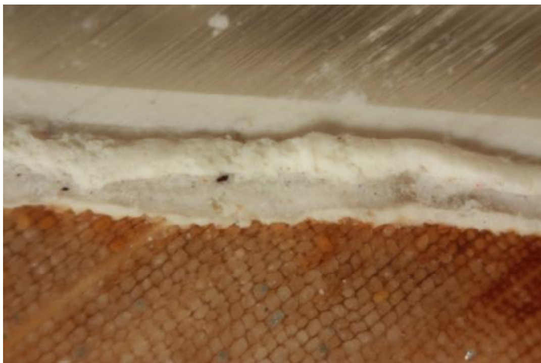
Fot.112 Przekrój próbki 15. Na próbce oznaczono 5 warstw, lecz na odkrywce zaobserwowano co najmniej 6. Oryginalne są dwie pierwsze warstwy – biała (1) podkładowa i szarozielona (2) wykończeniowa
