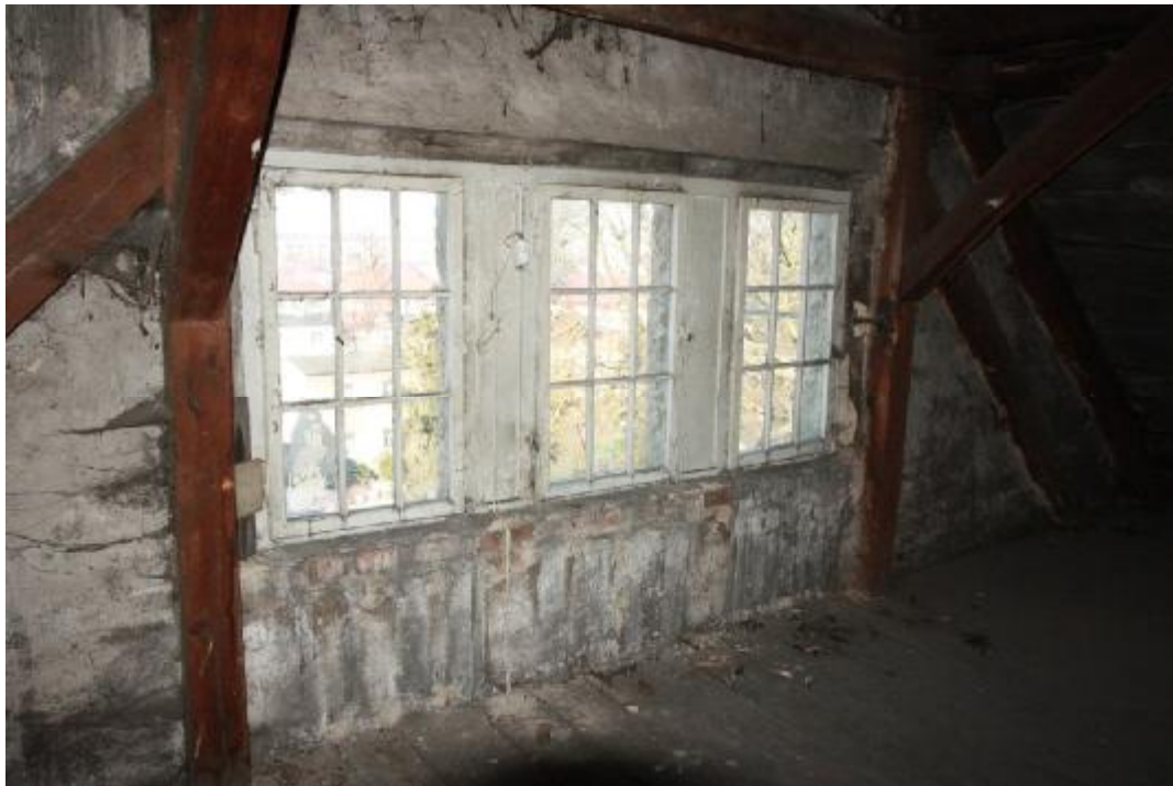
Fot. 73 Trzy oryginalne okna na strychu, na elewacji frontowej, są mocno zniszczone i nieszczelne.
