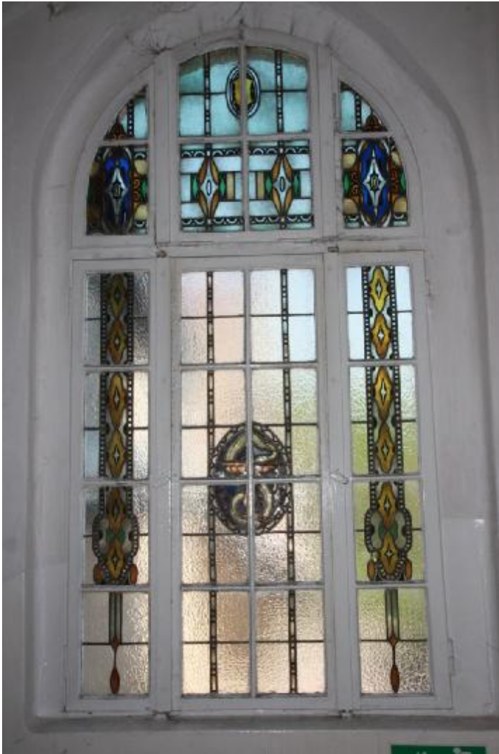
Fot. 38,39 W całości oryginalne okno z witrażem na pierwszym półpiętrze głównej klatki schodowej. W witrażu dominują motywy geometryczne. W centralnym miejscu umieszczono wizerunek węża Eskulapa. Witraż zachowany jest dobrym stanie. Posiada tylko niewielkie ubytki i pęknięcia.
