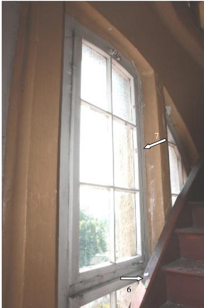
Fot. 84 Jedno ze skrzydeł (uchylne) oryginalnego, półkolistie zwieńczonego okna, przy schodach prowadzących na strych. Zaznaczono miejsce pobrania próbek 6 i 7.
