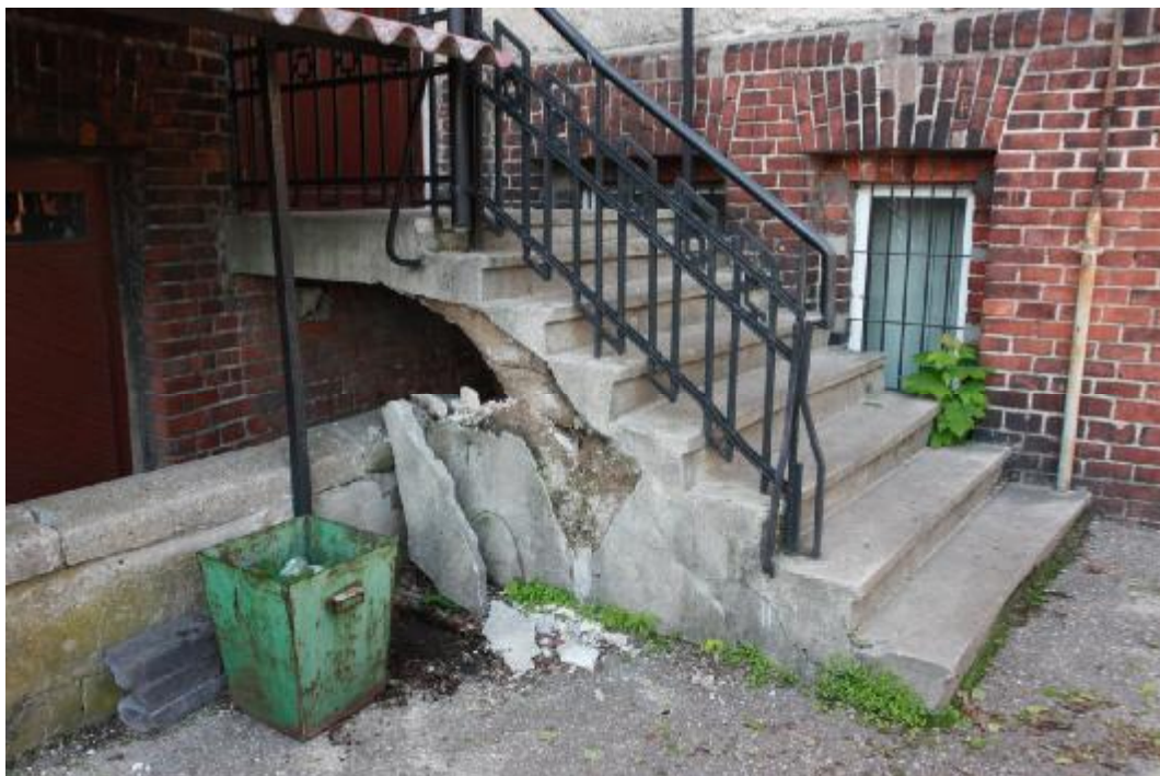
Fot. 25 Fragment elewacji Pd – Zach. Zewnętrzna, betonowa warstwa schodów traci przyczepność i pęka. Podobne pęknięcia występują na betonowych murkach.
