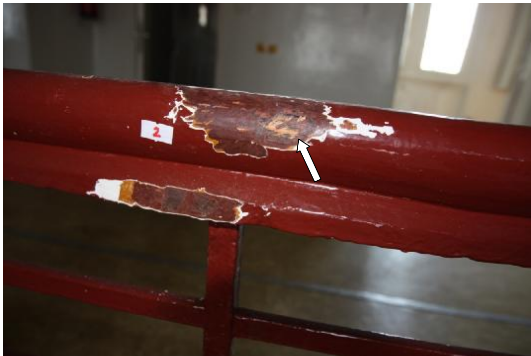
Fot. 80 Fragment poręczy na II piętrze głównej klatki schodowej. Wykonano odkrywkę i pobrano próbkę 2.
