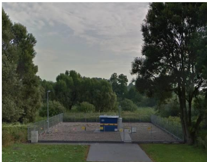
Zdjęcie. Stacja redukcyjna gazu w części południowo-zachodniej terenu opracowania.
