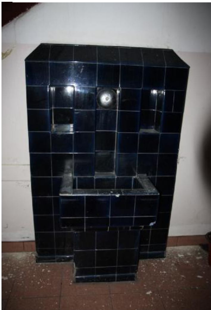
Fot 59. Ujęcie wody pitnej wykonane z kafli ceramicznych w kolorze granatowym.
