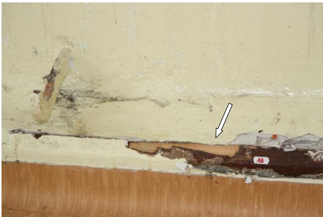
Fot. 120 Miejsce pobrania próbki 18 z listwy przypodłogowej. Listwę częściowo zasłonięto wykładziną PCV.
