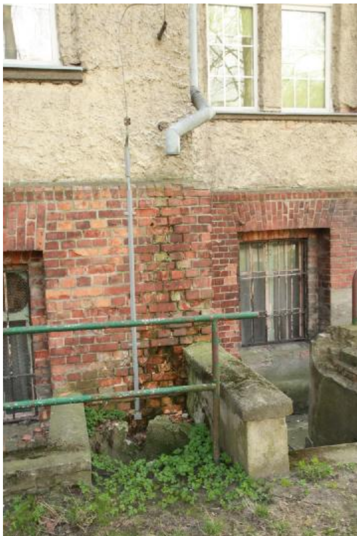
Fot. 36, 37 Północny narożnik budynku. Widoczne zacieki na murze i zniszczenia cegieł spowodowane lejącą się wodą opadową z urwanej rury spustowej. Obok duże ubytki w murku. W tym kształcie jest on konstrukcją wtórną.
