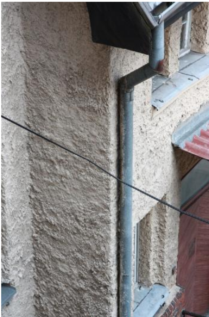
Fot. 28 Widoczne na rurze spustowej ślady zachłapania zaprawą tynkarską świadczą o tym, że tynk obecny na elewacji jest wtórny.
