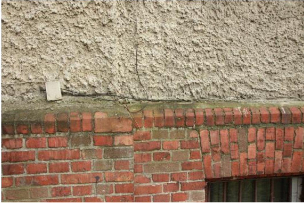
Fot. 32 Elewacja frontowa. Zatopiona w tynku współczesna instalacja świadczy o tym, że tynk jest nieoryginalny. Na cokole widoczne liczne nienajlepiej dobrane uzupełnienia ubytków.
