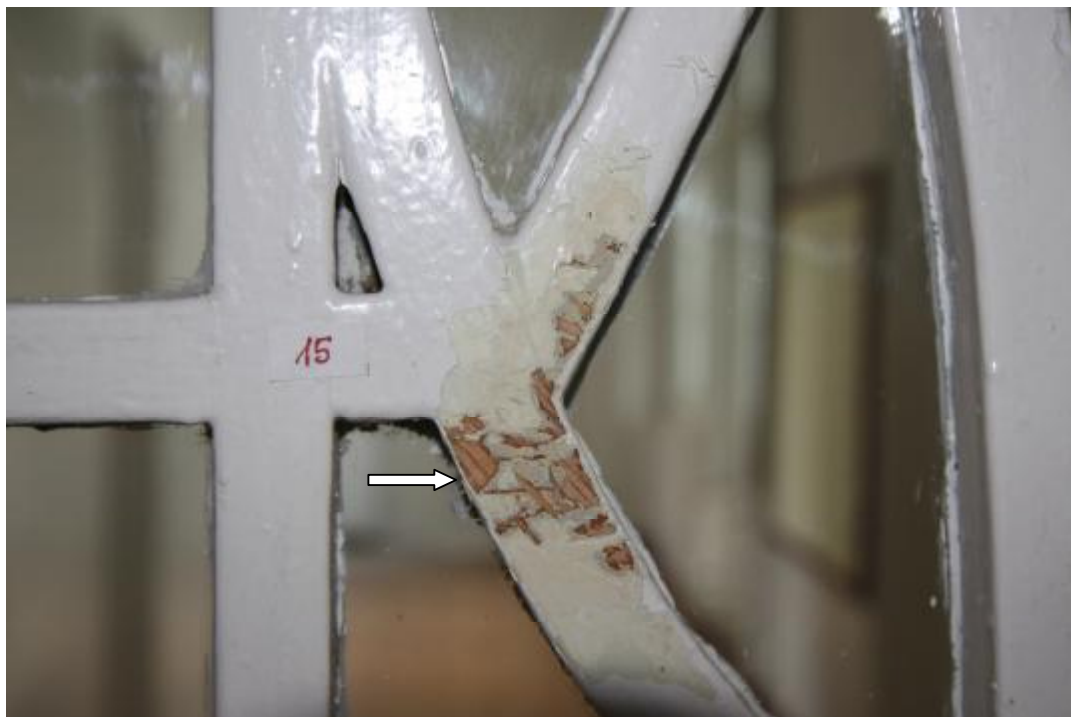
Fot. 111 Fragment drzwi wahadłowych na I piętrze. Wykonano odkrywkę i zaznaczono miejsce pobrania próbki 15. Zauważyć można, że drzwi zawsze malowane były białą farbą w różnych odcieniach
