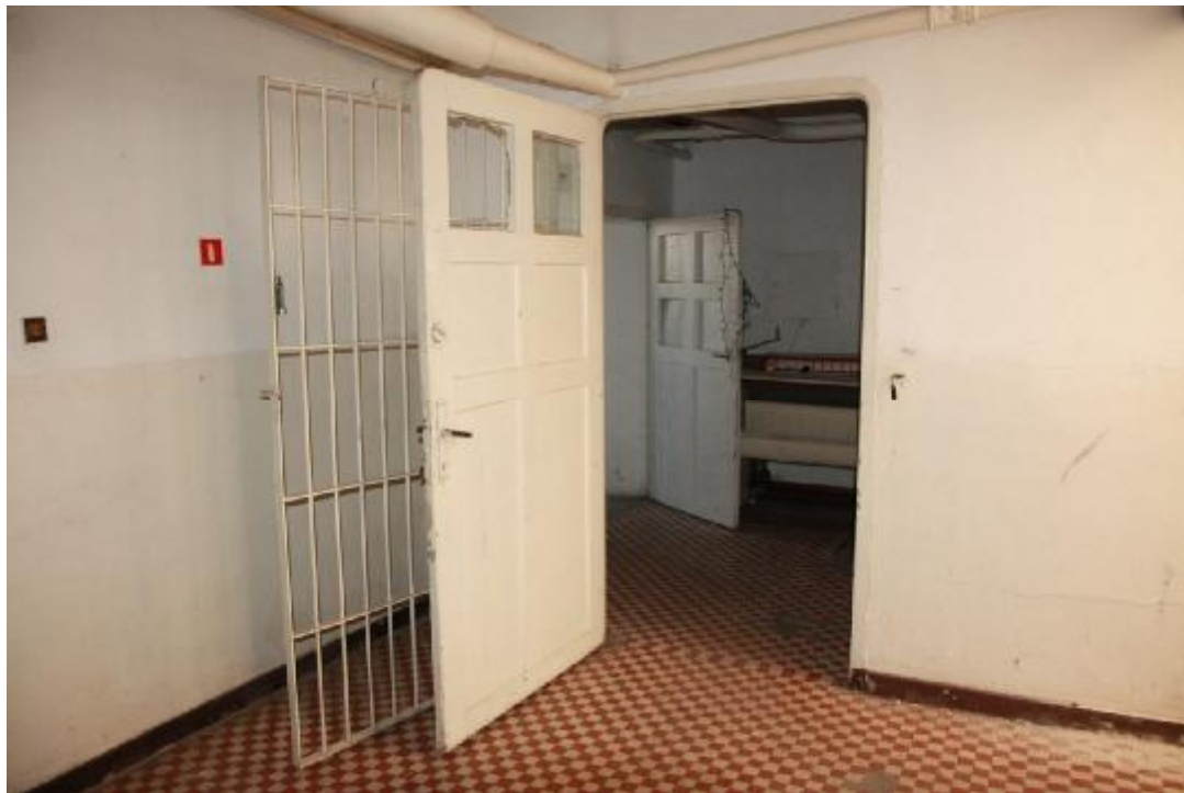
Fot. 69 Przejścia do pomieszczeń gospodarczych w piwnicy. Na podłodze oryginalna posadzka z kafli ceramicznych.
