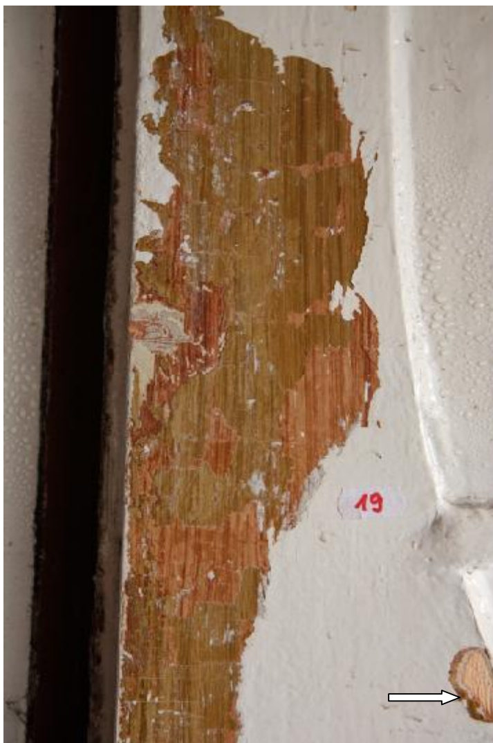
Fot. 123 Odkrywka na wewnętrznej stronie drzwi głównych wykazała, że drzwi posiadały szlachetną dekorację malarską – mazerunek., w kolorze jasnobrązowym i oliwkowym. Na drzwi położono go wielowarstwowo. Zaznaczono miejsce pobrania próbki 19.
