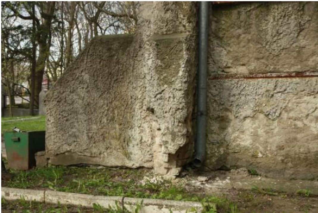
Fot.31 Fragment bocznej ściany ganku głównego wejścia. U dołu wyłaniają się spod tynku białe, betonowe cegły, które zastosowano przy przebudowie ganku.
