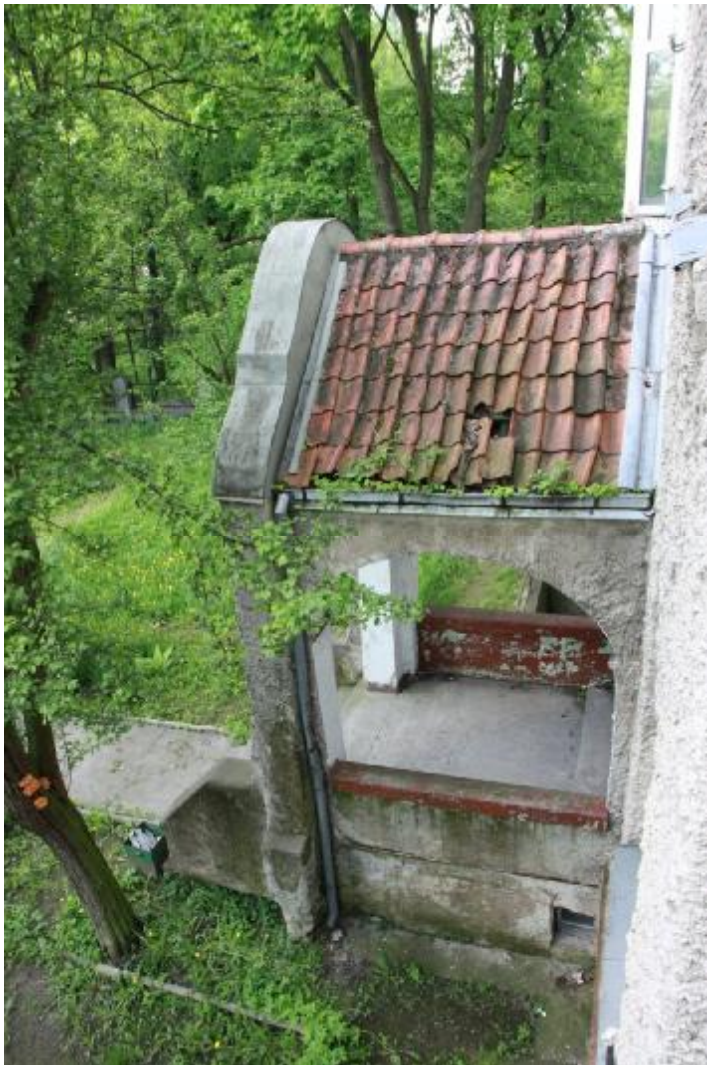
Fot 11, 12 Ganek głównego wejścia. Widoczne uszkodzenia dachu. Pierwotnie z obu boków ganku były podjazdy.
