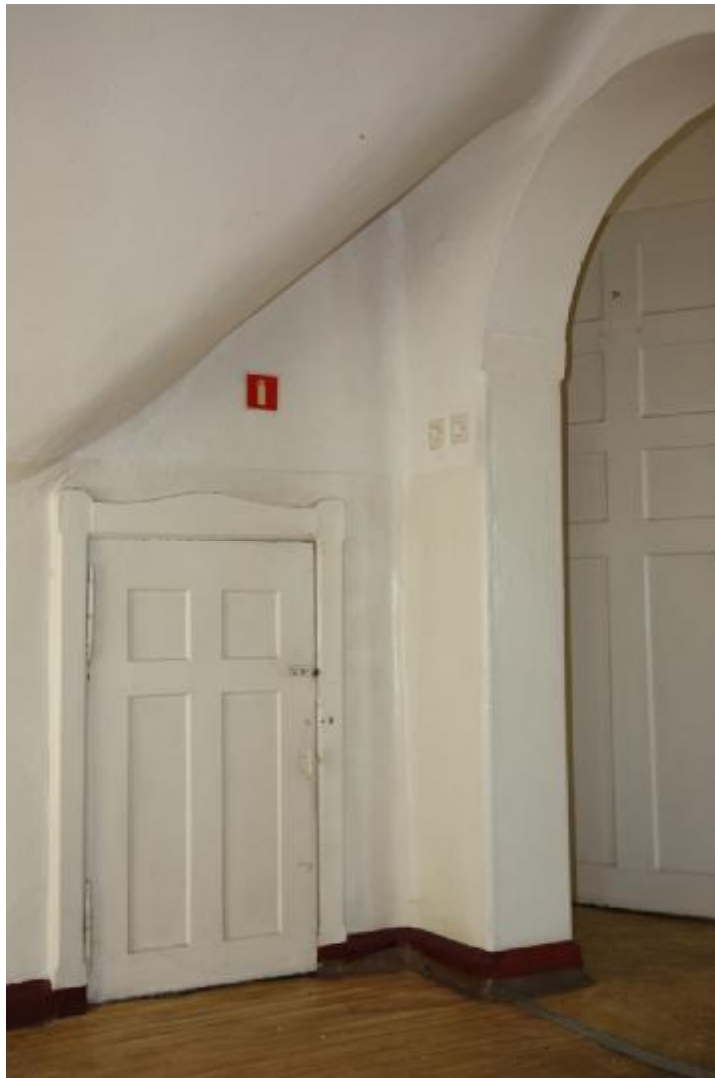
Fot. 54 II piętro w głównym skrzydle budynku. Małe drzwi prowadzące na nieużytkowe poddasze.
