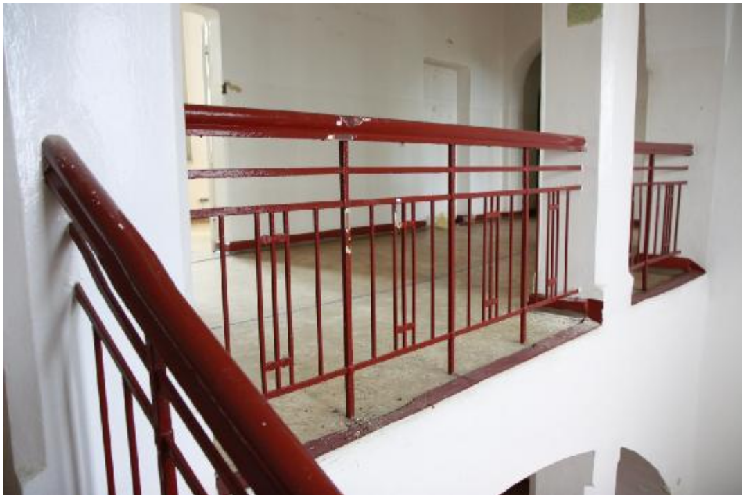
Fot. 77 Balustrada na II piętrze. Zaznaczono miejsca pobrania próbek do badań.
