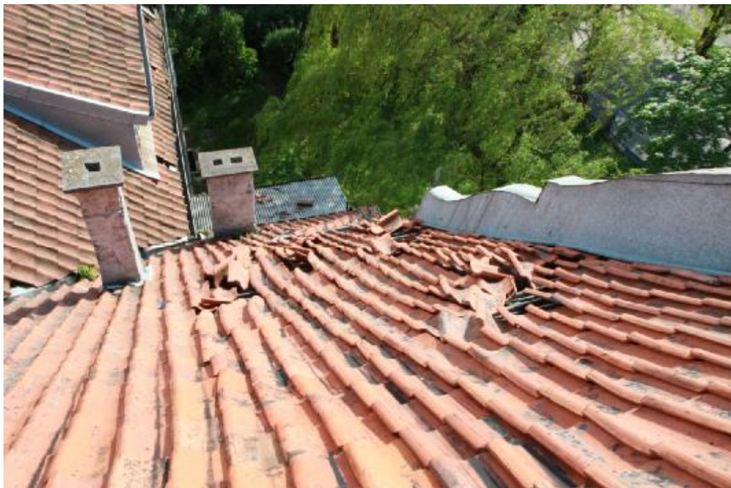
Fot. 16 Fragment dachu nad lewym ryzalitem elewacji frontowej (nad wejściem głównym). Widoczne silne uszkodzenia dachówek.
