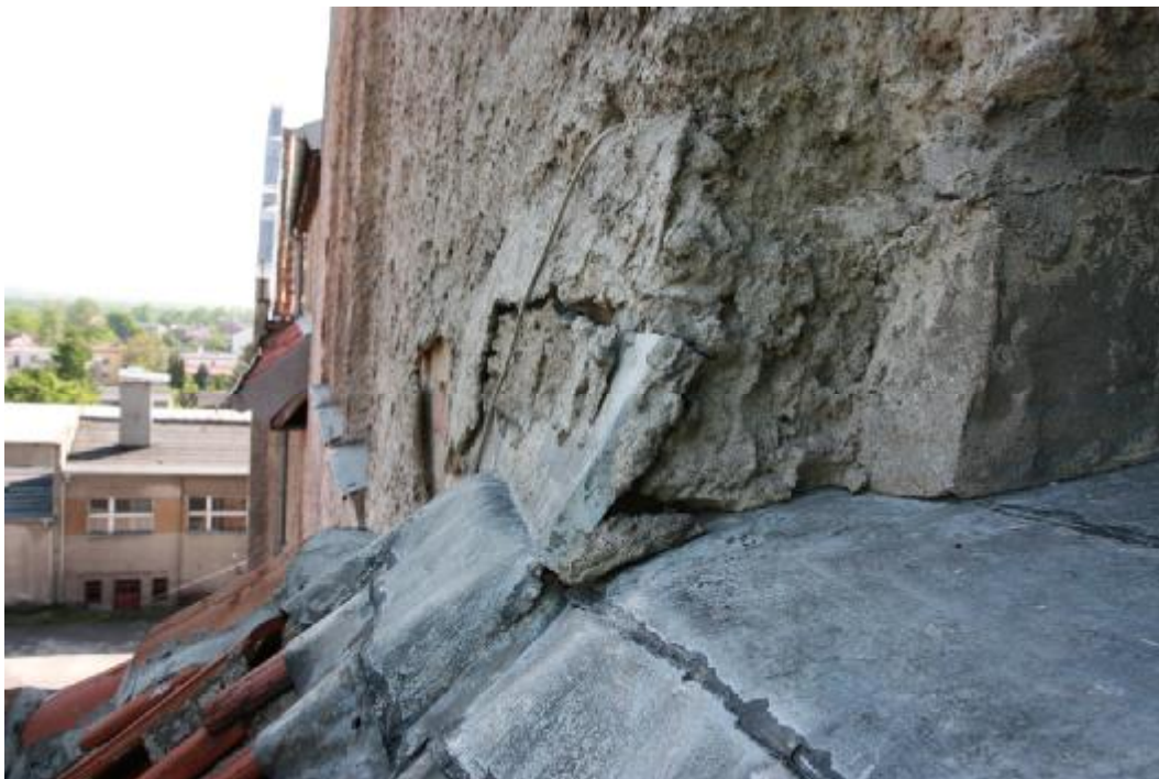
Fot. 29 Fragment parapetu na elewacji Pd-Wsch. Widać, że tynk zarzucono na obróbki blacharskie. Potwierdza to jego wtórność.
