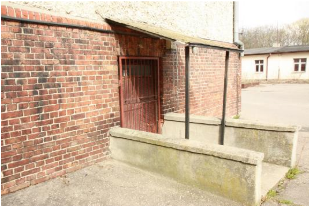
Fot 34, 35 Wtórne zadaszzenia występują w różnych miejscach na elewacjach. Pierwotnie daszków i murków przy wejściach nie było w ogóle.
