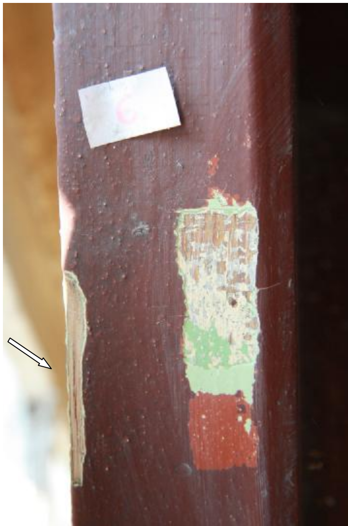
Fot. 90 Odkrywka na policzku schodów prowadzących na strych. Zaznaczono miejsce pobrania próbki 6. Na odkrywce można zaobserwować, że najwcześniejszą warstwą malarską jest biało-beżowa, a bezpośrednio na niej widać resztki warstwy błękitnej, której nie zarejestrowano na zdjęciu mikroskopowym. Kolejne przemalowania były zielone, w kolorze sieni i brązu.
